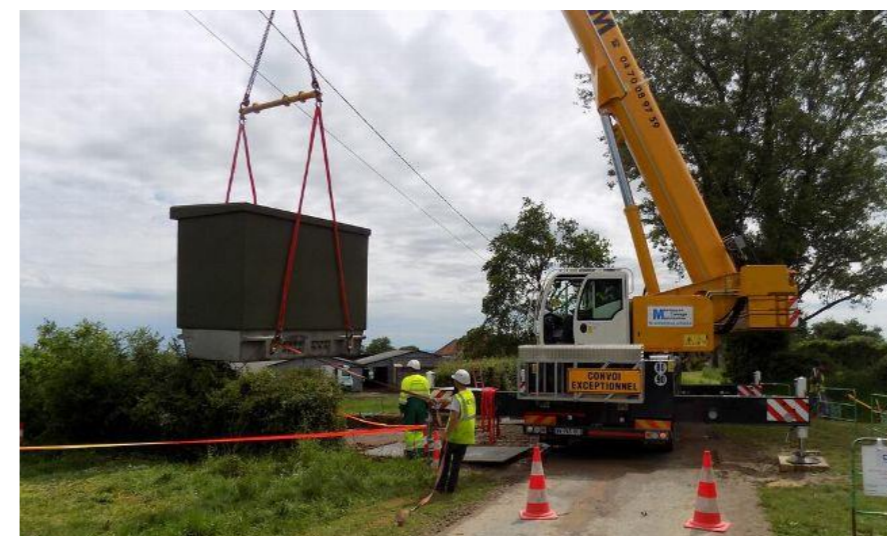
Exemple d'installation d'un local technique dans le cadre de la mise en œuvre d'un projet photovoltaïque
