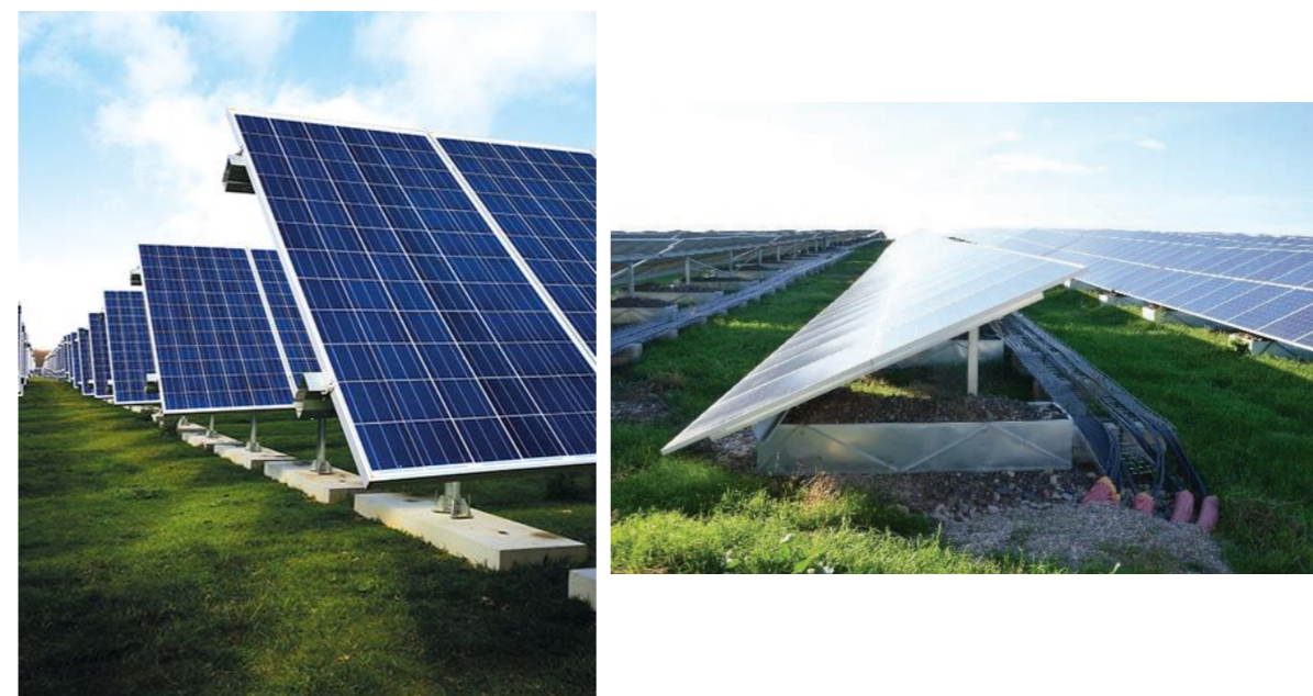
Exemple de structures photovoltaïques en longrine béton (gauche) ou gabions (droite) Source : EneR CENTRE-VAL DE LOIRE
