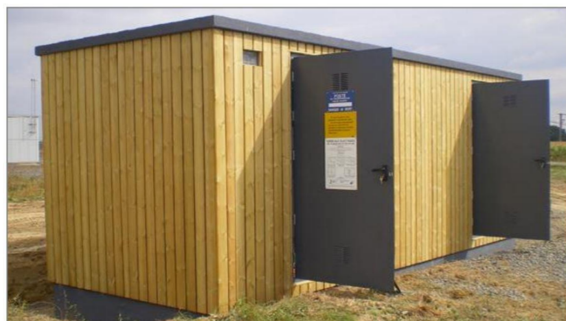
Exemple de poste de livraison Source : EneR CENTRE-VAL DE LOIRE
