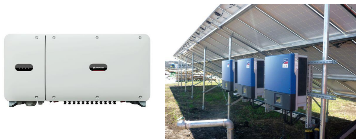
Exemple d'onduleurs photovoltaïques et installation à l'arrière des structures
