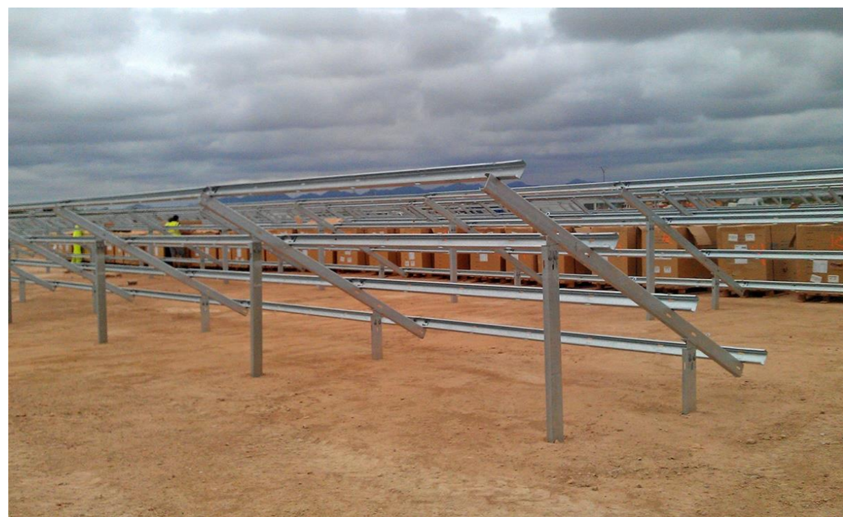
Exemple de structures photovoltaïques sur pieux battus Source : EneR CENTRE-VAL DE LOIRE
